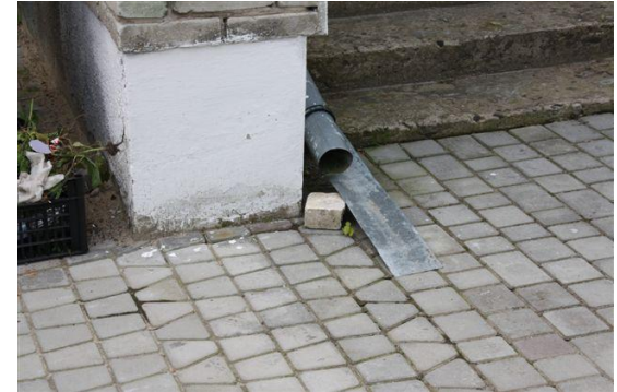
3.) no sewage drain
