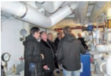
Die Besichtigung der Hausanschlussstation im Grabenviertel in Hellersdorf stieß auf großes Interesse.
