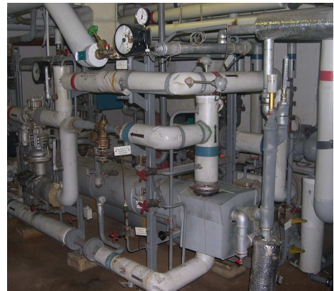
Hausanschlussstation (HAST) alt, mit liegendem Wärmetauscher (Quelle: calitect Ingenieurbüro)
